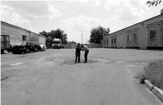
Рис. 18. Замкова гора, ур., центральна частина. Рештки провалу колодязя на в'їзді до території ВІА «Трейд». Із заходу.
